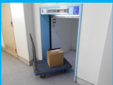
ダムウェーター (荷物専用のエレベーター)
