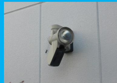
建物入口防犯カメラ
