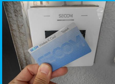
建物入口セキュリティ (夜24時～朝6時は入館不可)
