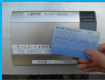
建物入口セキュリティ (夜24時~朝6時は入館不可)
