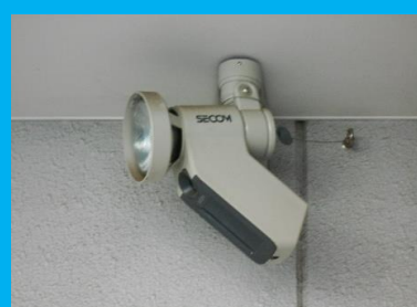
建物入口防犯カメラ
